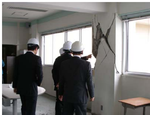
平成23年12月6日 参議院文教科学委員会視察 茨城県東海村立東海中学校の校舎被災状況（筆者撮影）
